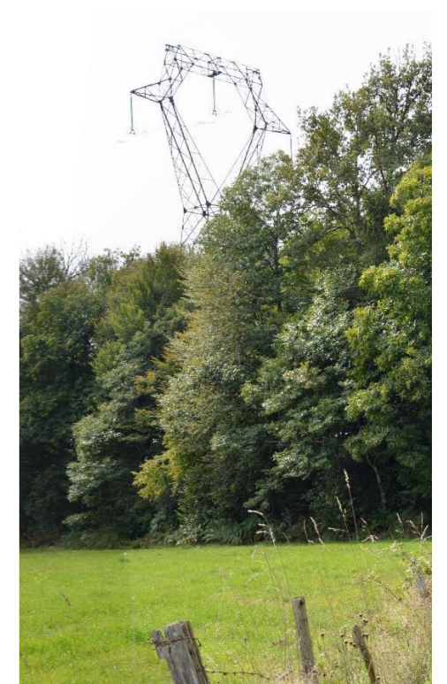
Photographie 68 : Pylône dans l'AEIm.
